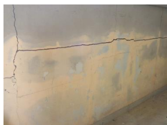
図3. 補修前の教室の壁
